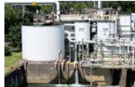
生物排水処理設備
