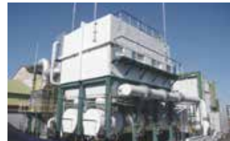
蓄熱式燃焼脱臭装置
