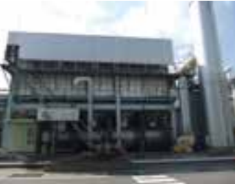
蓄熱燃焼設備: 揮発性有機化合物排出対策、悪臭対策
