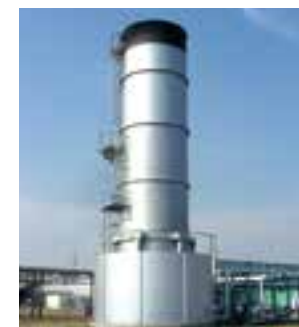
グランドフレアー（環境対策設備）
